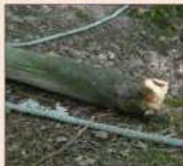
Cassé à la base, le poteau devra être remplacé pour sécuriser ce "trou de sarrasin", nom donné aux ouvertures de l'aqueduc romain par où passaient les esclaves. Photo Le Progrès/T. L.
